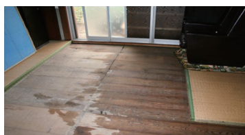
(d) Inundation above the floor level
